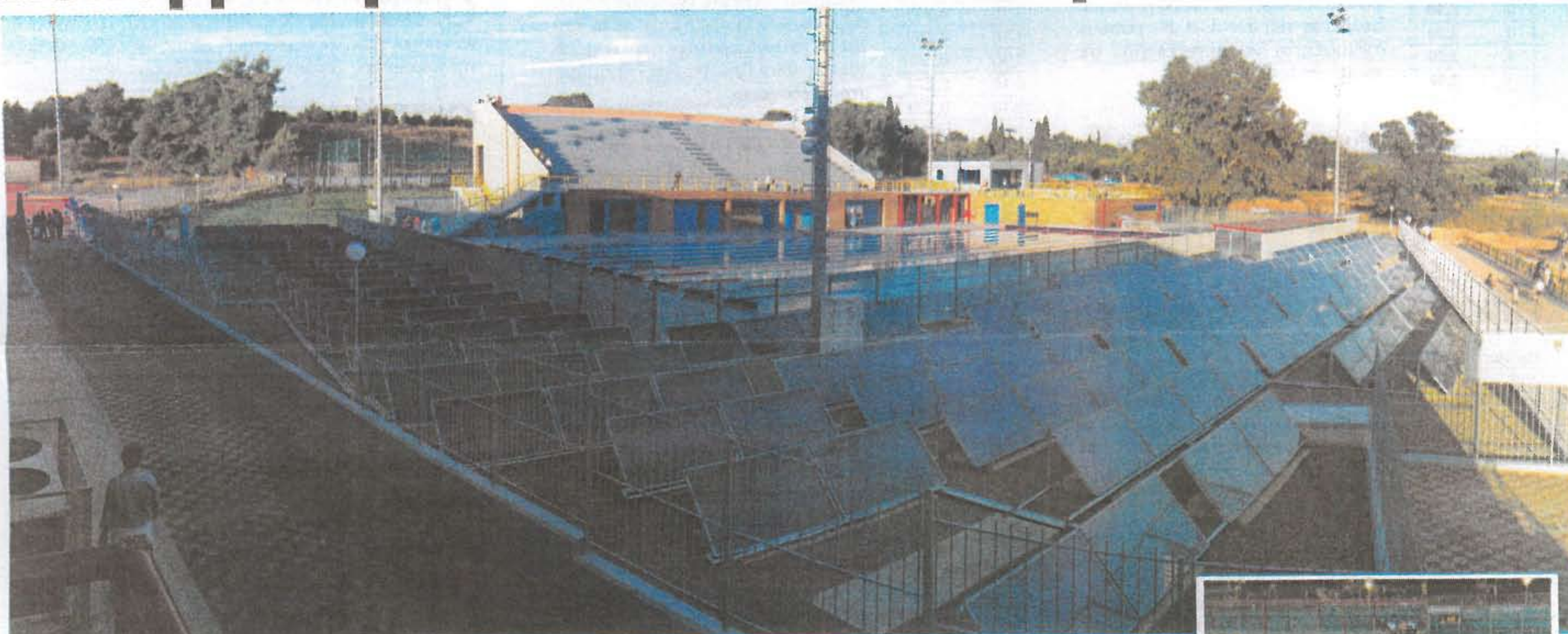
Οι εγκαταστάσεις του ηλιοθερμικού συστήματος στο κολυμβητήριο Αμαλιάδας
